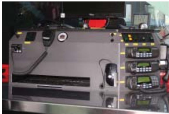
Spezielle Funkgeräte, Telefon und Fax sowie Computer mit Internet stehen für die Feuer- wehr zur Verfügung
