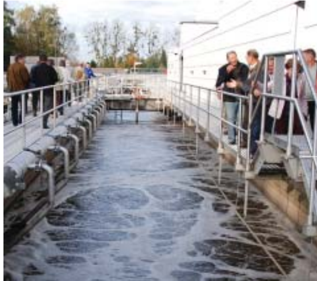
Belebungsbecken der Kläranlage
